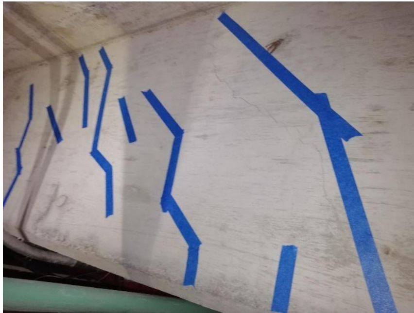
Figura 10 Fallas detectadas en trabes, durante recorridos de inspección visual.
